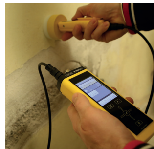
Un relevé avec un hygromètre numérique dans un local enterré avec des infiltrations.
