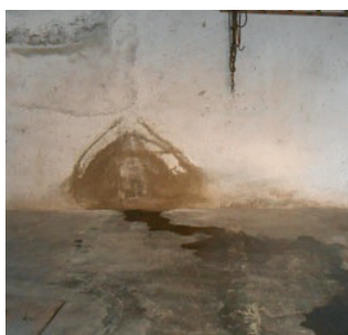
Un local touché par des infiltrations d'eau
